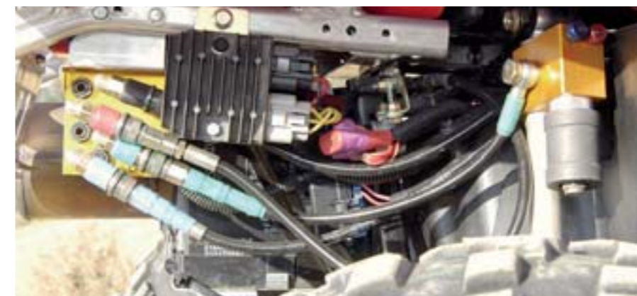
La instalación, a pesar de parecer voluminosa y complicada, queda perfectamente integrada en poco espacio.
